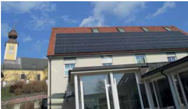
Der 44 kWh Batteriespeicher zur Photovoltaikanlage wurde im Marktgemeindeamt in Betrieb genommen.
